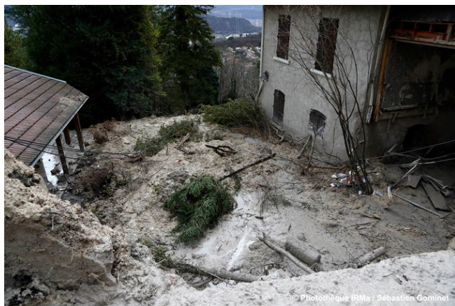
Glissement de terrain à Claix, 2018
